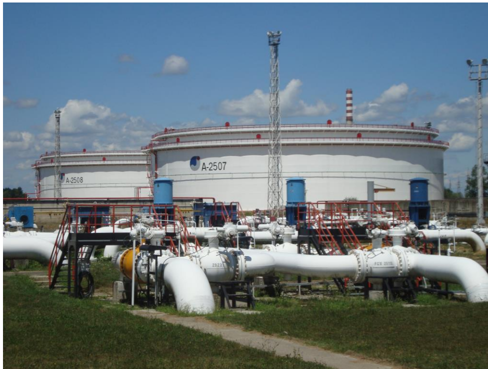
Slika 16. Spremnici – Terminal Sisak
