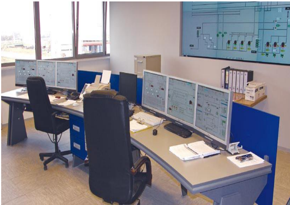
Slika 21. Kontrolni centar SCADA u Sisku
